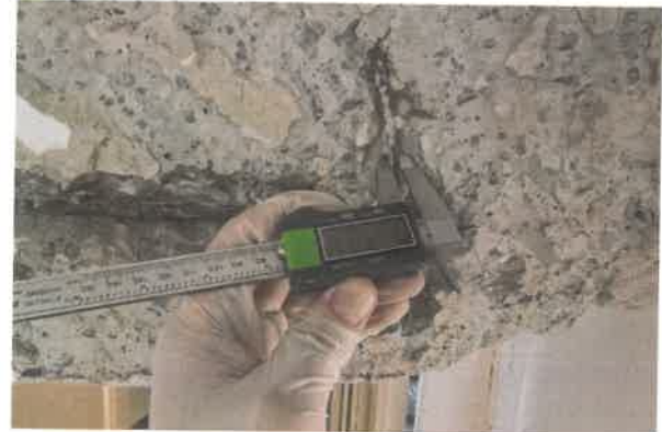
Sondaj GR01 grinda beton armat monolit ax 3,C-D, etaj 2: sectiune transversala 30x60cm, armare longitudinala 4Ø16 PC52, armare transversala Ø6 OB37/35cm;
