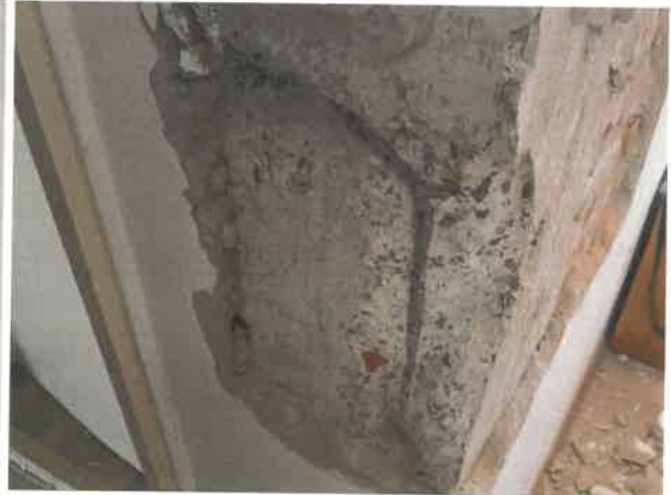
Sondaj SZ01 sambure beton armat monolit ax 3-C, etaj 2: sectiune transversala 30x30cm, armare longitudinala 4Ø14 PC52, armare transversala Ø6 OB37/30cm.
